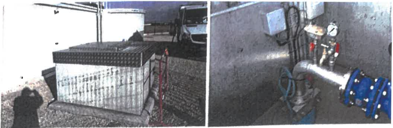
Figure 5. Installations de surface F1
